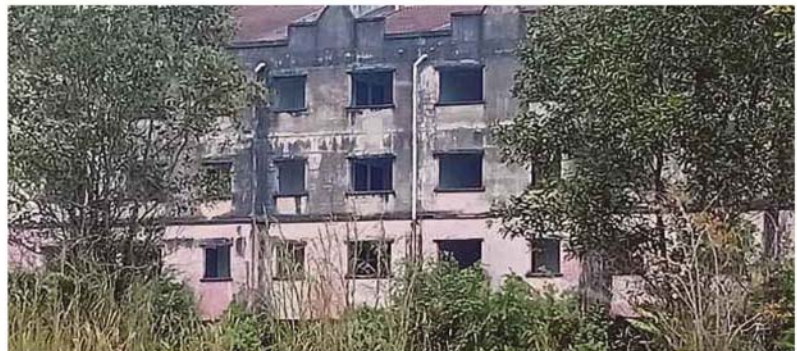
Bangunan lot kedai yang usang dan bersemak samun di Taman Widuri dan Kemboja, Bukit Sentosa, terbiar sejak 1995 mengundang masalah kepada penduduk. (Foto Md Fuzi Abd Lateh/BH)
